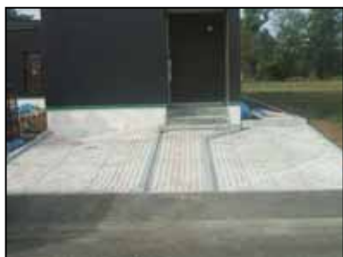
写真 架橋ポリ配管状況1
